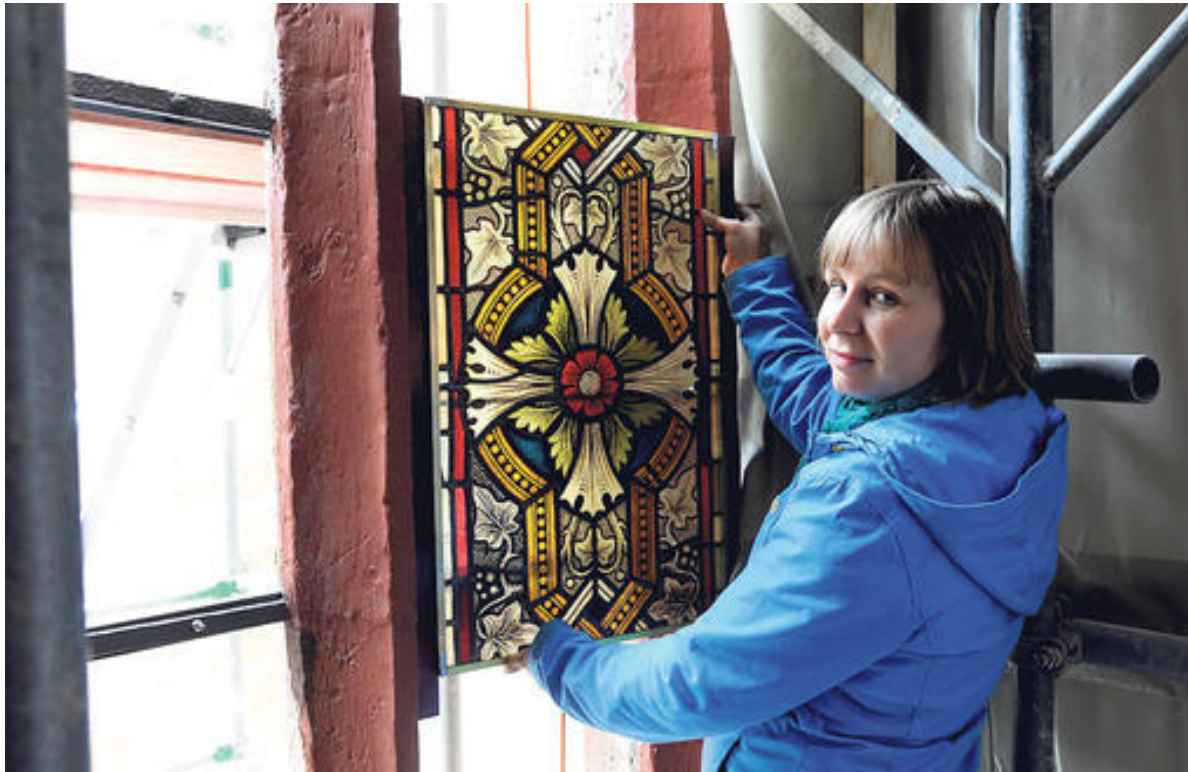
Sanierung an St. Jacobi: Kathrin Rahfoth zeigt ein Teilstück des acht Meter hohen Fensters.
